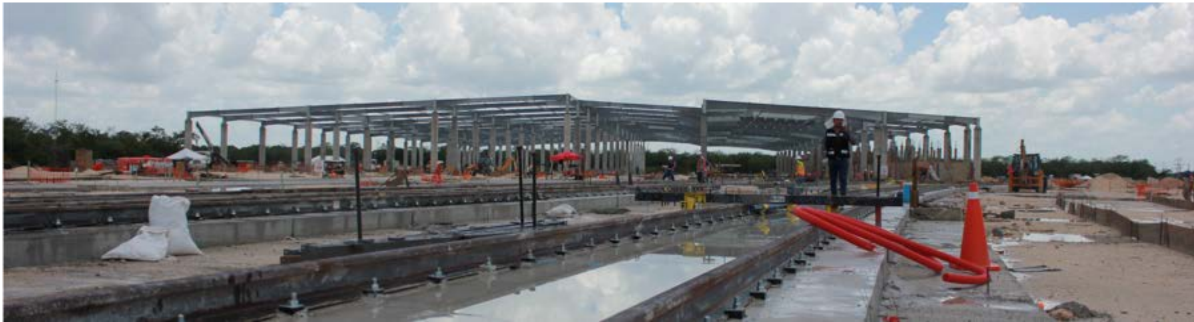
Talleres y cocheras Tren Maya, Mérida Mérida, México
